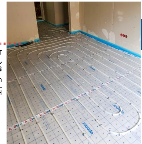
PROJEKT STRESEMANN-QUARTIER, HAMBURG 18.000m 2 FBH Tackersystem AG H+E Haustechnik und Elektro GmbH
