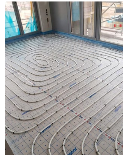
PROJEKT EUROPACITY BERLIN 12.000m 2 FBH Tackersystem AG H+E Haustechnik und Elektro GmbH
