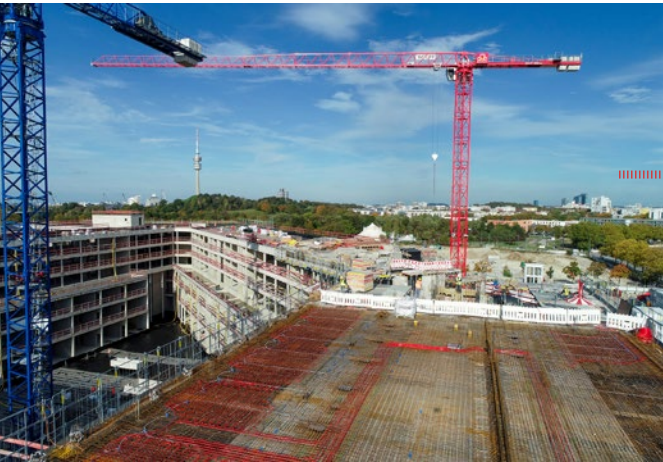
PROJEKT NEUBAU STRAFJUSTIZ- ZENTRUM MÜNCHEN 18.000m 2 Betonkern- aktivierung AG Dechant Hoch- und Ingenieurbau GmbH
